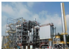
前橋バイオマス発電所
