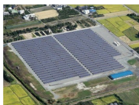
久留米太陽光発電所
